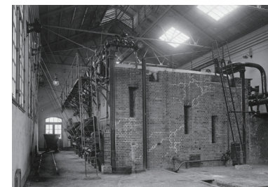
動力源のボイラーは、建設当時圧倒的シェアを占めていたバブcock&ウィルコックス社製。
