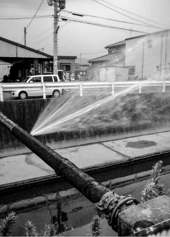
↑川の上にかかっている水道管が破裂し、水が勢いよく 吹き出す様子。もし、同じことが道路に埋設された水道 管で起きたらどうなるでしょう…。
