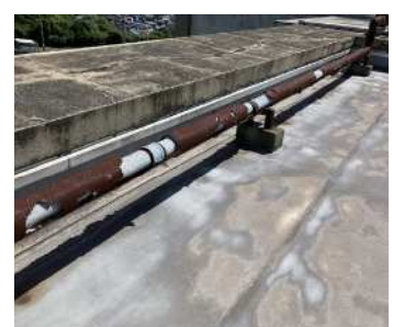
図：施設の老朽化状況（中間東中学校）
