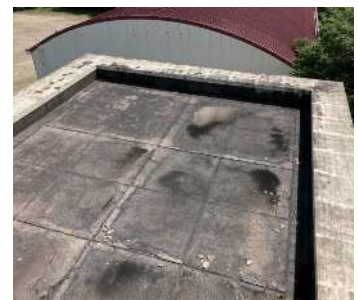
図：施設の老朽化状況（中間中学校）
