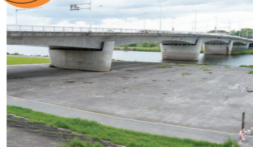
↑遠賀橋の下は、日よけや雨宿りに利用できるように簡易舗装しました。
