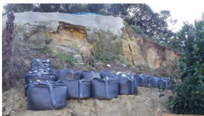
岩瀬南町の法面崩落現場
