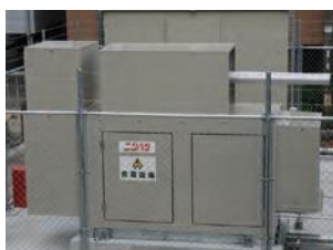
市役所敷地内に設置された非常用電源装置
