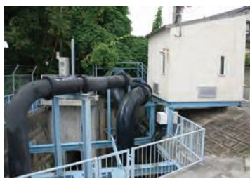
出原ポンプ場（土手内）
