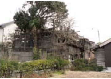
老朽化した空き家
