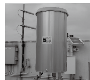
市役所屋上に設置された雨量計。電力は太陽光発電で賄われる。
