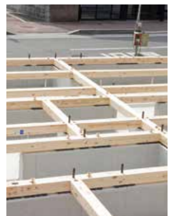
空き家バンク制度を利用して、中古住宅を解体し、新築に建て替える中の物件。ここから家族の新しい生活が始まる。
