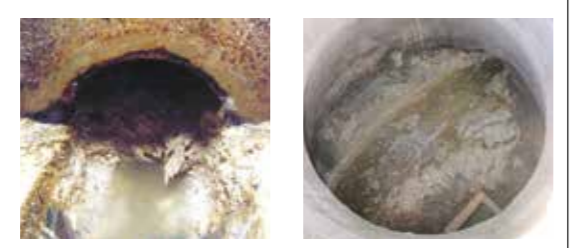
油やごみが堆積して固まり、管が詰まっている様子。水が流れにくくなると、悪臭が起る。
