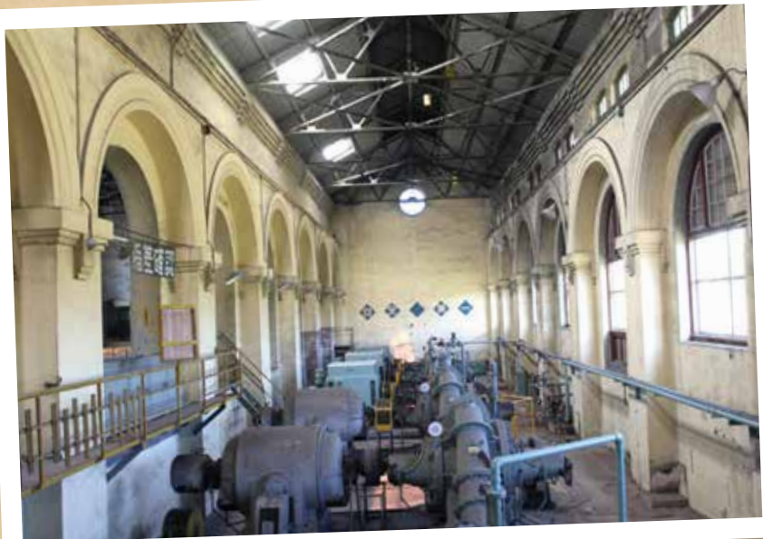
八幡製鐵所遠賀川水源地ポンプ室内部（現在）
