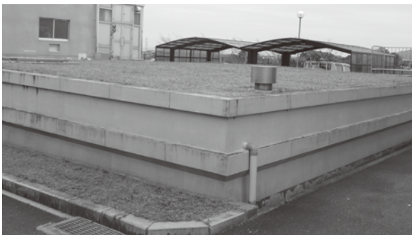
▲唐戸浄水場 浄水池
